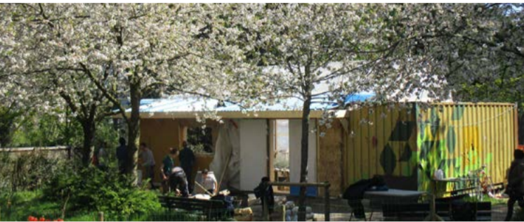
Square Emmanuel Fleury Paris 20 ème : chantier participatif d'un mur paille enduit co-organisé par le Collect'IF Paille
